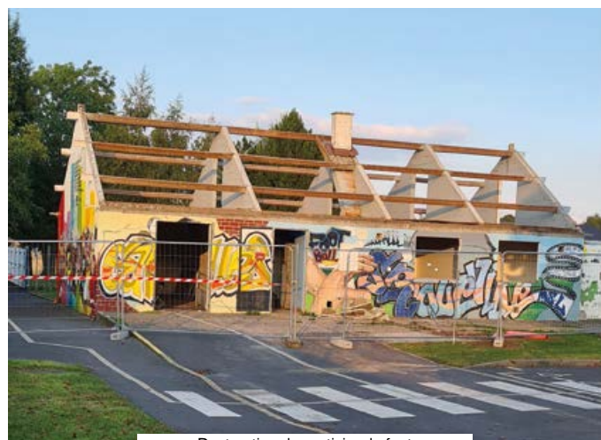
Destruction du vestiaire de foot
